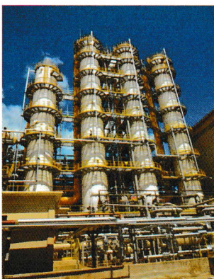
Рис. 6. Установка Клауса линии очистки газа PT Krakatau POSCO
