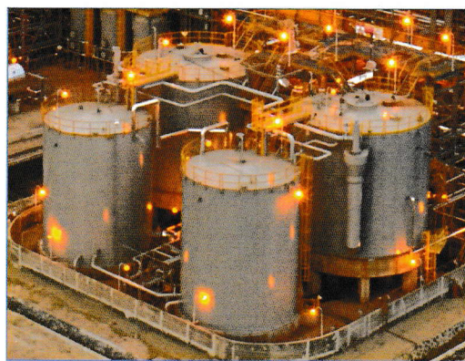
Рис. 4. Установка отделения смолы и водосборники установки PT Krakatau POSCO
